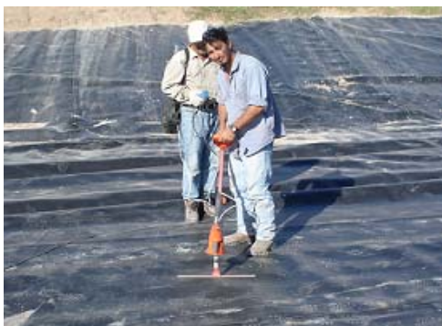
Fig. 6 Control de impermeabilidad, detectando fugas, mediante dispositivo VATEM (Verificador de alto voltaje electromagnético)
