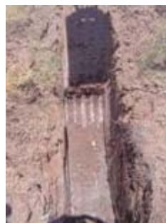
Fig. 3 Calicata en zona de la balsa, yesos masivos.
