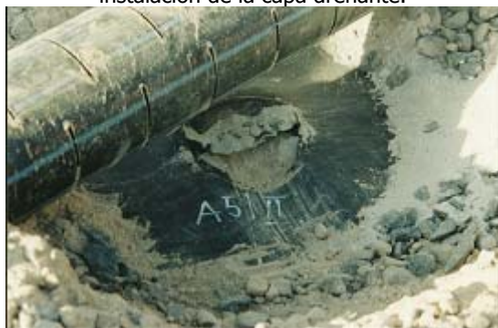
Fig. 16 Daño en la membrana, zona tubo de drenaje
