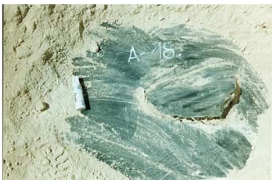
Fig. 15 Daño en la geomembrana, producido durante la instalación de la capa drenante.
